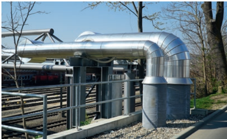
Kommunale Fernwärmenetze sind ein wesentlicher Baustein für die Entwicklung der Wohnungswirtschaft in Richtung Klimaneutralität.
