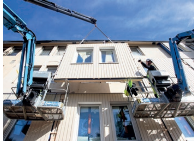
Großflächige Teile der Holzfassaden werden angeliefert und in einem Schritt am zu sanierenden Gebäude angebracht.
