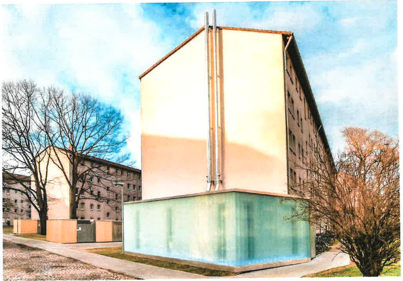
Im „Smarten Quartier Karlsruhe-Durlach“ wurde die konventionelle Energieversorgung durch ein intelligent gesteuertes klimafreundliches Energiesystem ersetzt
