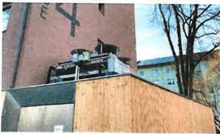
Außenlufteinheit der Mehrquellen-Wärmepumpenanlage auf einem Müllhäuschen in Karlsruhe
